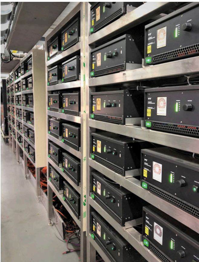
Die 72 Sonopower 3S Generatoren befinden sich in einem klimatisierten Raum und sind mit einer optionalen Profibus-Schnittstelle ausgestattet. Sie ermöglicht die Steuerung der Schwinger aus der Ferne. (Bildquelle: Weber Ultrasonics AG)
