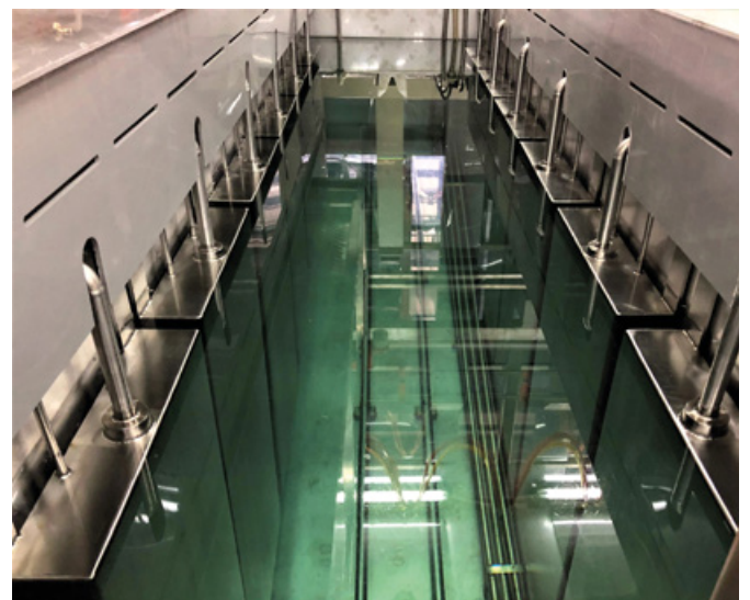
Jedes Becken der Reinigung ist mit zwölf Tauchschwingern mit 25 kHz ausgestattet. (Bildquelle: Weber Ultrasonics AG)
