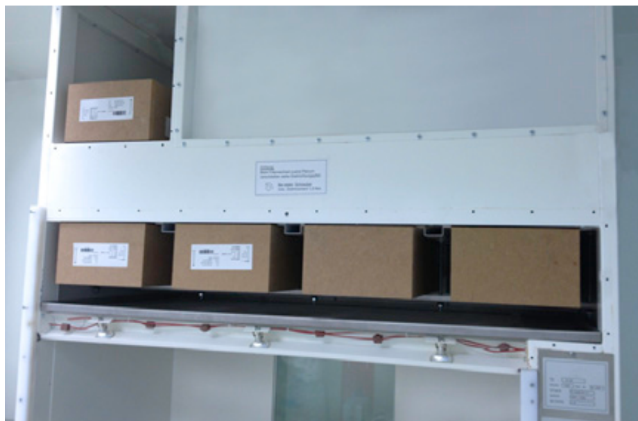
Nicht für das Gerät zugelassene Filter der Klasse H14. Filter können nicht kontaminationsarm gewechselt werden (Eine Hauptforderung der DIN 12980). Wechsel mit aufwändigem Unterdruckfolienschutzzelt erforderlich. Filter führen zu signifikant abweichendem Strömungsverhalten.
