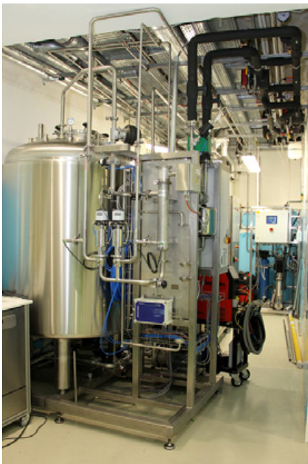
Abb. 6: Blick auf die Reinstwasseranlage
