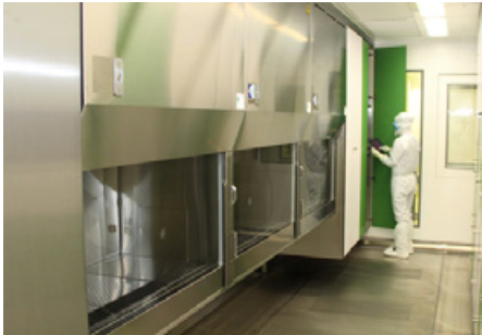
Abb. 5: Frei „schwebende“ Sicherheitswerkbenke, Laminarflow und V4A Doppelboden im Umgebungsbereich
