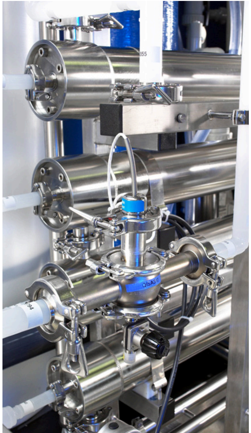
Anlagenverrohrung mit PVDF-HP (Reverse Osmose 2.000 l/h heißwassersanitierbar) © Werner GmbH
