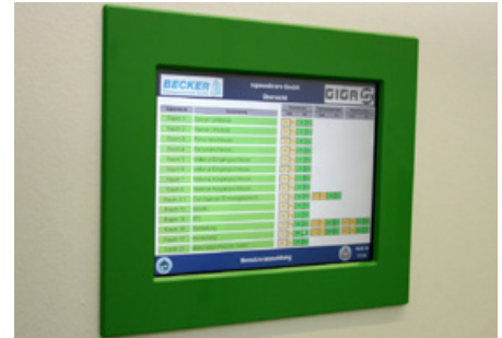
Abb. 8: Zentrales Bedienterminal zur Steuerung aller Anlagenteile
