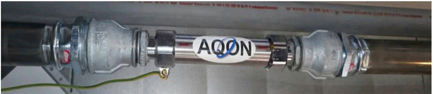
Bild: ASB Kundeninstallation in 1" Wasserleitung
