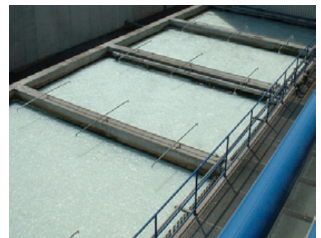
Biofiltration BIOFIT F zur weitergehenden Abwasserreinigung in einem großen Projekt der Papierindustrie, in dem Hager + Elsässer ihr neues AOP-Verfahren umgesetzt haben.
