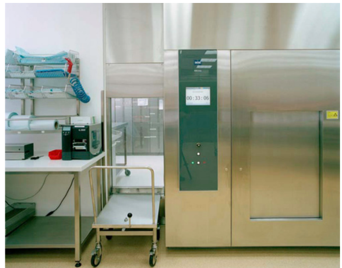
Beispiel Zentralsterilisation, Beladeseite Sterilisation (Bildnachweis: HWP Planungsgesellschaft mbH, Foto: Peter Horn)
