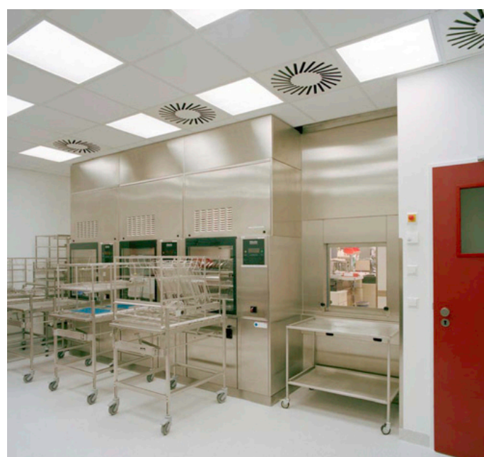
Beispiel Zentralsterilisation: Reinigungs- und Desinfektionsgeräte (Bildnachweis: HWP Planungsgesellschaft mbH, Foto: Peter Horn)
