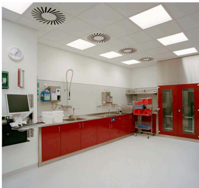
Beispiel Zentralsterilisation: Unreine Seite, Vorreinigungszone (Bildnachweis: HWP Planungsgesellschaft mbH, Foto: Peter Horn)
