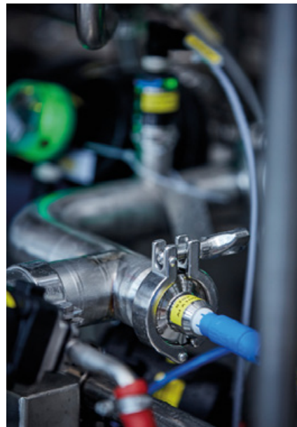
Abb. 2: Nach dem Reinigungslauf (CIP) wird die Anlage mit Reinstwasser gespült («final rinse»). Dieser Vorgang wird mit konduktiven Leitfähigkeitsmessungen überwacht, hier mit digitaler Schnittstelle. (Bild: Endress+Hauser)
