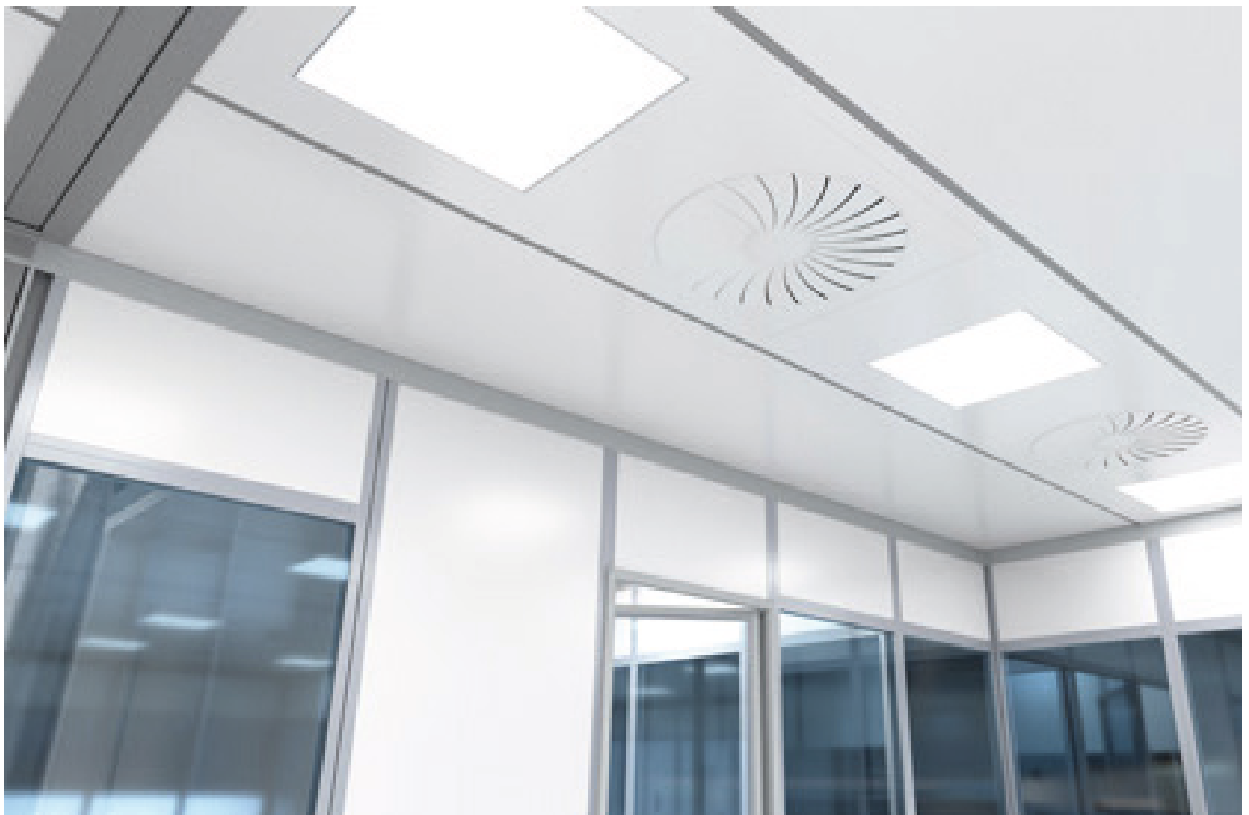
Leistungsstarke Lüftungs- und Klimatechnik mit reinraumtauglichen Zu- und Abluftfiltern (Foto: KLEUSBERG GmbH & Co. KG)
