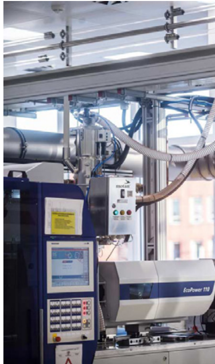
Jeder der Drucklufttrockner hat eine lokale Steuerung, die über Profibus mit der Zentralsteuerung kommuniziert. (Foto: motan-colortronic)
