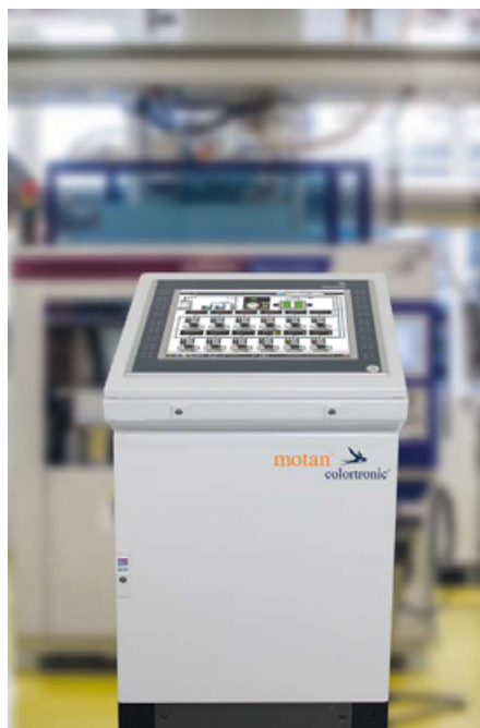
Bedienen und überwachen lässt sich die gesamte Anlage über die Visualisierung LINKnet 2 im Reinraum oder über die Zentralsteuerung. (Foto: motan-colortronic)
