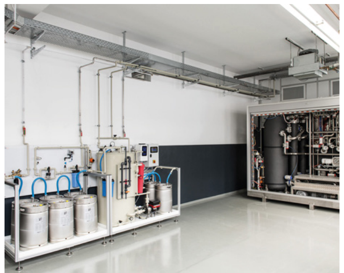
Wasseraufbereitung (Foto: LPW)
