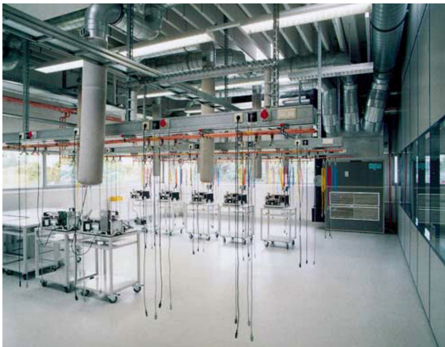
Produktionshalle der Inficon GmbH in Köln: ESD-Cleanroom Bodenbeschichtungssystem der Sto AG (dampfoffenes, wässriges System: StoPox WB 110)
