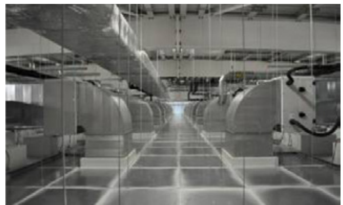
Bei den Reinräumen kamen spezielle Decken- und Wandkonstruktionen zum Einsatz. Außerdem wurde ein ausgeklügeltes Belüftungssystem mit einer abwärts gerichteten Luftströmung über Filter-Fan-Units konzipiert, das sehr energieeffizient arbeitet. (Quelle: Braunform GmbH)
