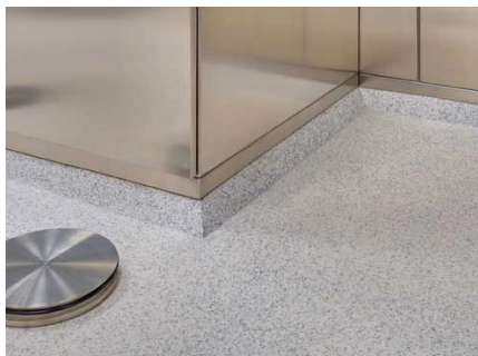
Sämtliche Bodenanschlüsse wie Podesteinbindungen, Reinraumabläufe, Gefälleausbildungen, Rohrdurchführungen, Bodenwaagen und andere Apparate sowie Dreikant-Wandbodenübergänge bleiben dicht und geschlossen. (Bildnachweis: © LEONHARD WEISS)
