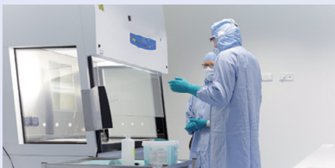
Komplettes Reinraumsystem, inkl. Wand-, Decke-, Bodensystem und Klimatechnik, MSR, Monitoring, Klasse B-D Krankenhausapotheke Gütersloh
